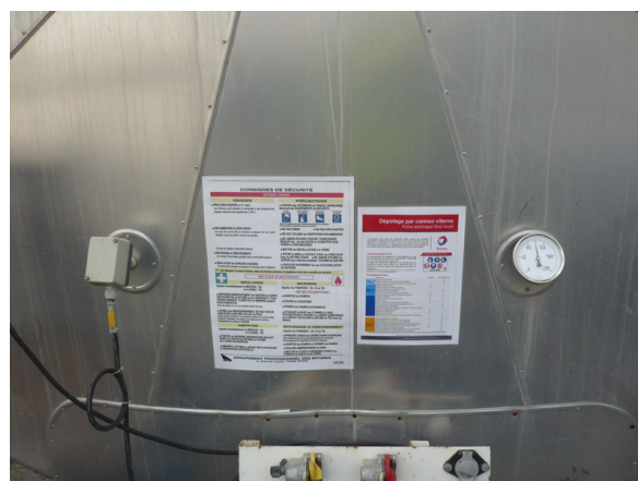
Exemple d'affichage de sécurité sur la cuve de bitume à proximité de la zone de dépotage
