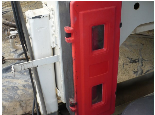
Extincteur portatif à poudre polyvalente
